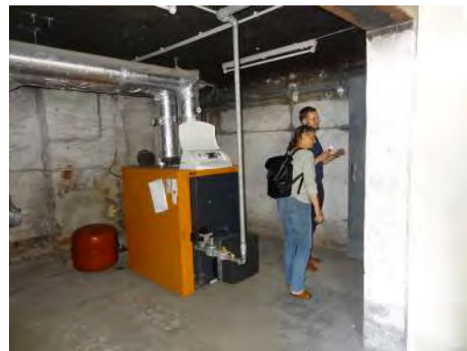
06 Heizungsanlage im Keller
